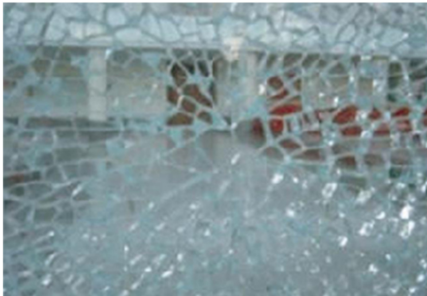
Imagen N°1 Rompimiento Espontáneo en el Vidrio Temperado
